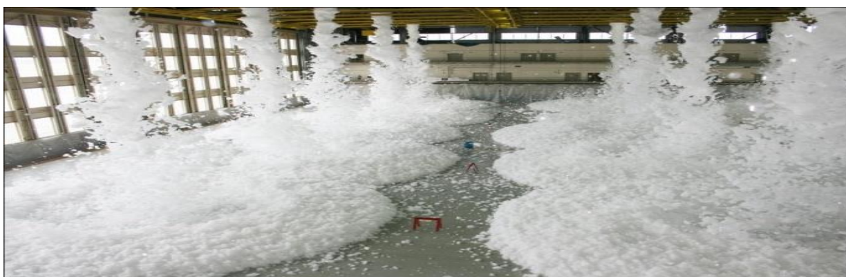
Рисунок 4 - Спринклерная установка пожаротушения
